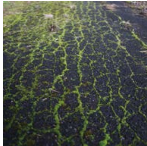
人も車も通らなくなったアスファルトに亀裂が入って、コケがはえはじめていました
